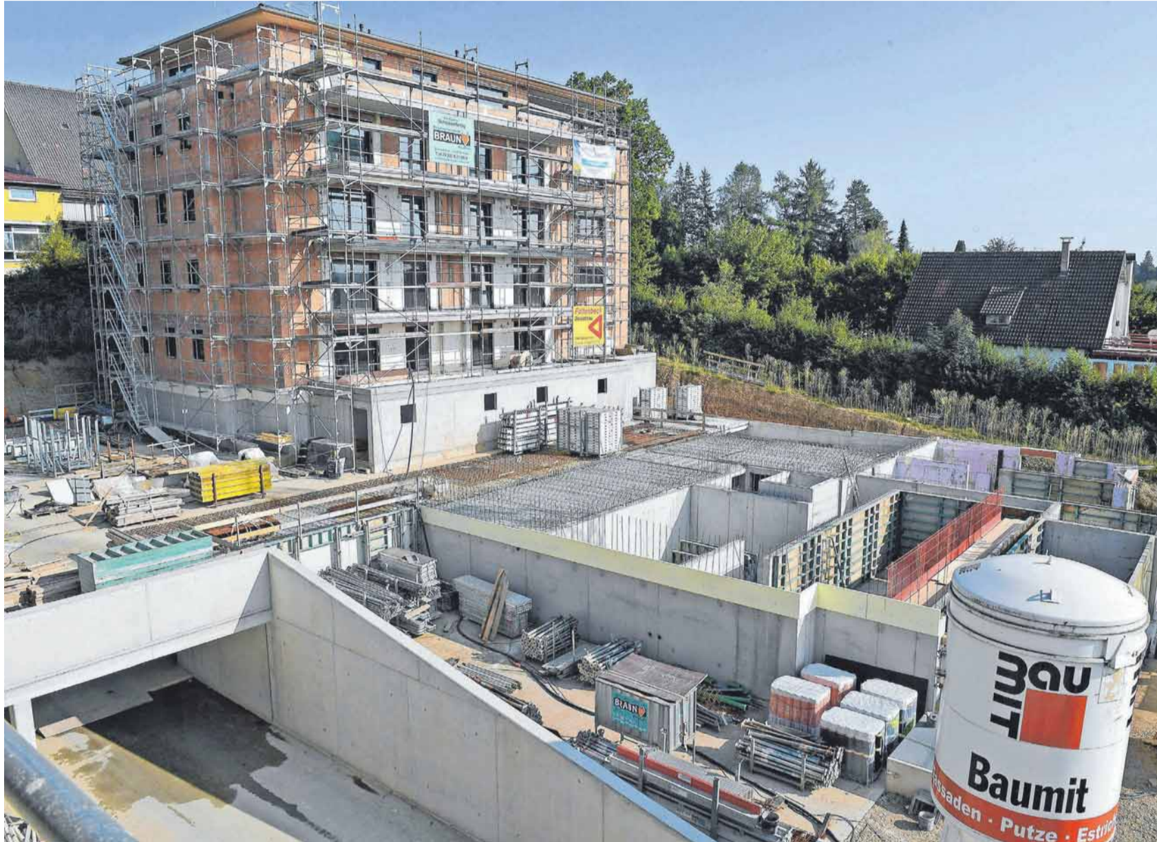
Die Tiefgaragenzufahrt, das Haus Kellerberg 11 im Rohbau und der Keller von Haus Kellerberg 13.
