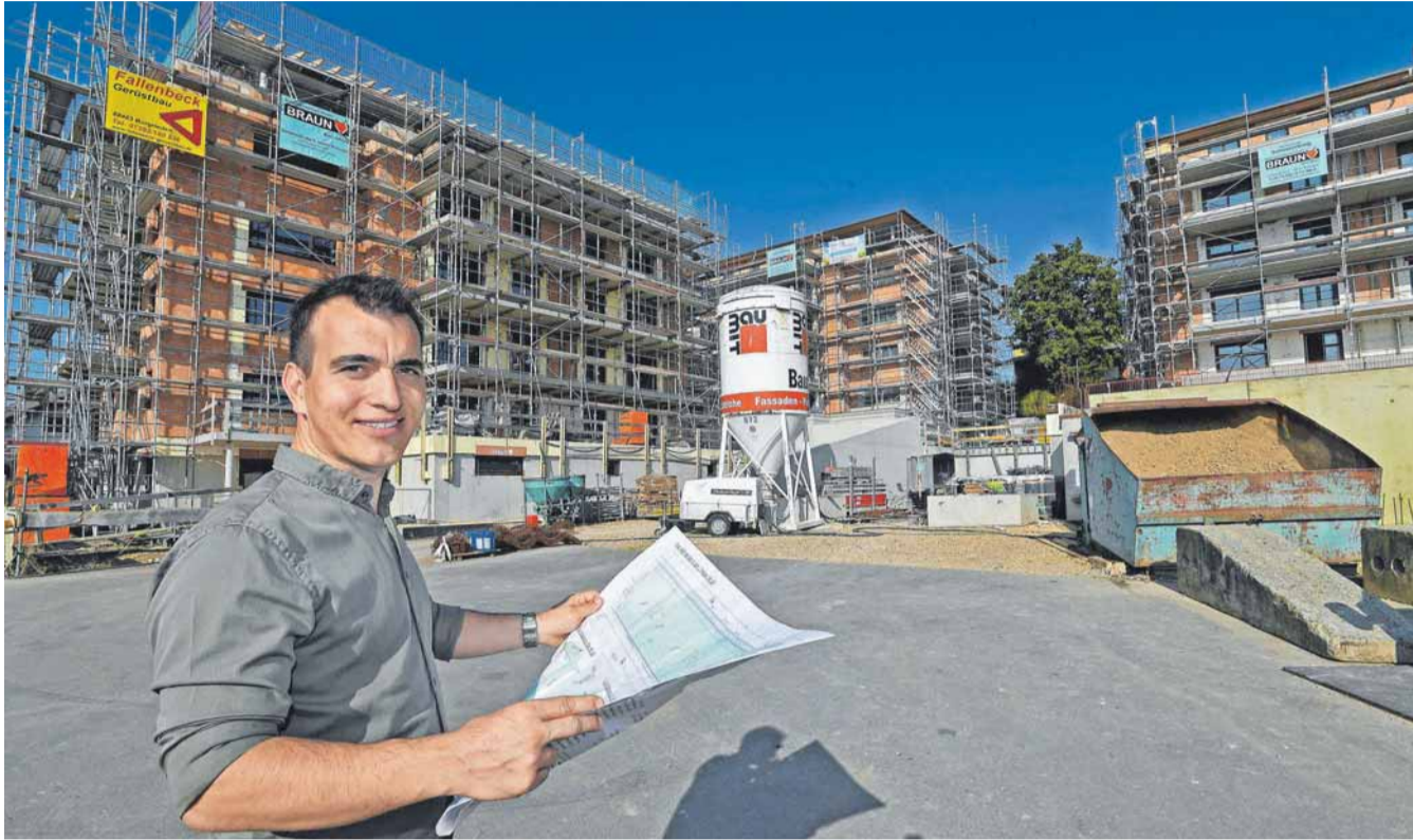
Thomas Rohmer vor der im Bau befindlichen Wohnanlage „Wohnen am Kellerberg“ in Schwendi.
